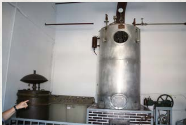
Caldera para producir el vapor que se utiliza en el proceso.
