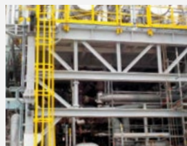
Protección pasiva contra el fuego
